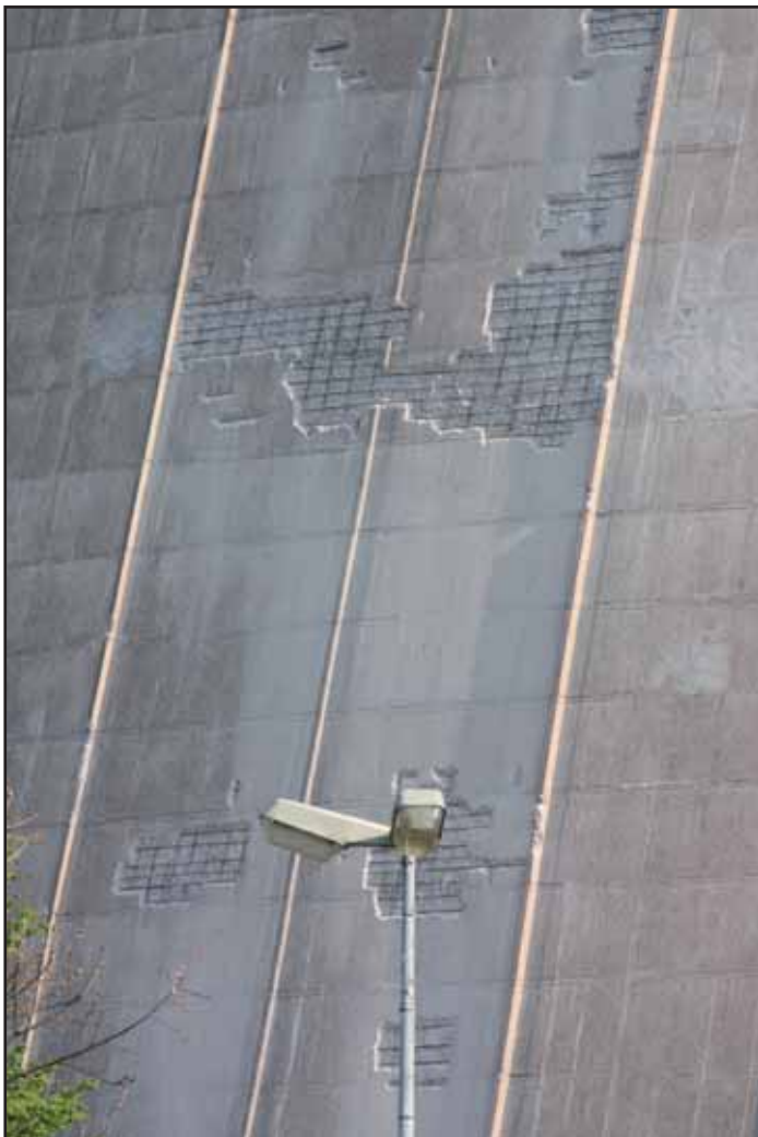
Frühjahr 2011: Am Kühlturm bricht großflächig der Beton ab. Wie wohl der sogenannte Betonsicherheitsbehälter von innen aussieht?
